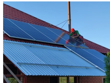
Казахстан / on grid Мощность: 5 кВт Тип: сетевая станция
