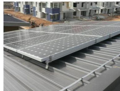
Сингапур / on grid Мощность: 150 кВт Тип: сетевая станция
