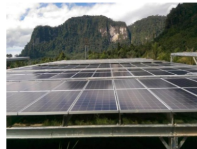
Малайзия / utility Мощность: 3 МВт Тип: гибридная станция
