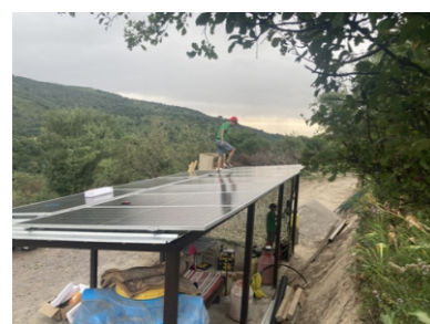
Казахстан / off grid Мощность: 5 кВт Тип: автономная станция
