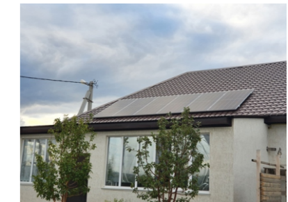
Казахстан / off grid Мощность: 3 кВт Тип: автономная станция
