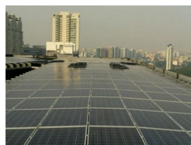
Сингапур / on grid Мощность: 700 кВт Тип: сетевая станция
