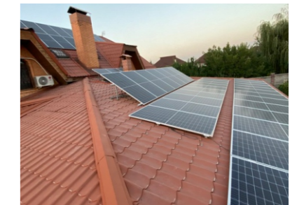
Казахстан / on grid Мощность: 30 кВт Тип: сетевая станция
