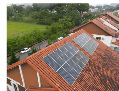
Малайзия / on grid Мощность: 15 кВт Тип: сетевая станция
