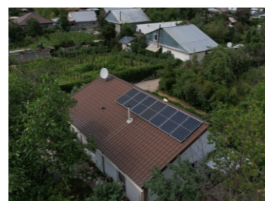
Казахстан / off grid Мощность: 3 кВт Тип: автономная станция
