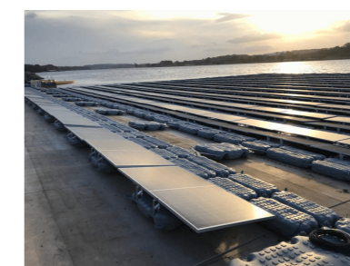
Сингапур / floating Мощность: 1 МВт Тип: плавающая станция
