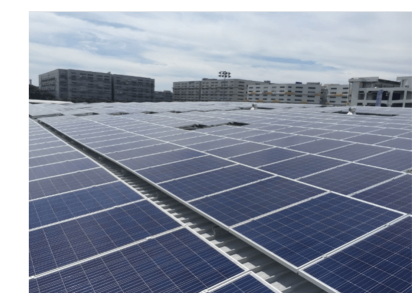
Сингапур / on grid Мощность: 500 кВт Тип: сетевая станция
