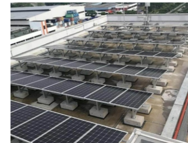
Сингапур / on grid Мощность: 40 кВт Тип: сетевая станция
