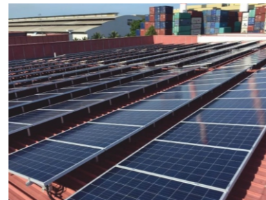
Сингапур / on grid Мощность: 214 кВт Тип: сетевая станция
