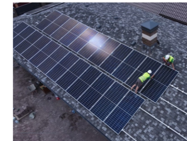
Казахстан / off grid Мощность: 20 кВт Тип: автономная станция
